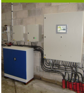
Панель управления 2,8 МВт
